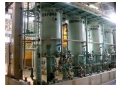
排水処理プラント
